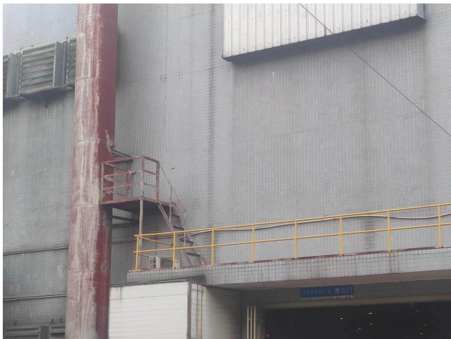
排气筒及采样平台
